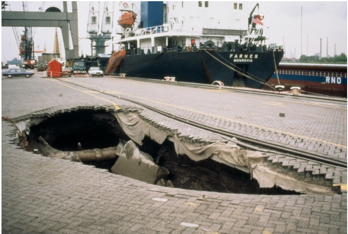
Figuur 2.24 Rotterdamse haven, gevolg van uitspoeling t.g.v. uit het slot gelopen damwand [van Weele]
