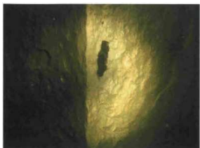
Microbiologisch geïnduceerde corrosie (MIC)
