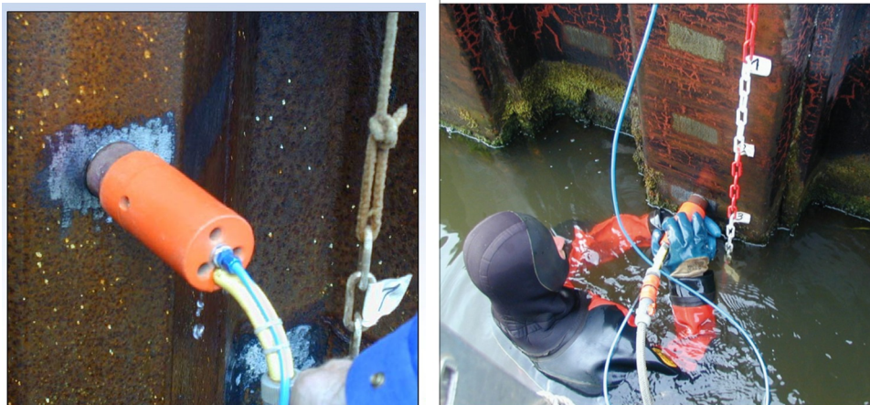
Figuur 3.2 Boven: tot op blank staal gereinigde damwanden. Onder: magnetisch bevestigde ultrasone meetapparatuur van BAW met enkelvoudig kristal en watervoorziening [BAW 2005]
