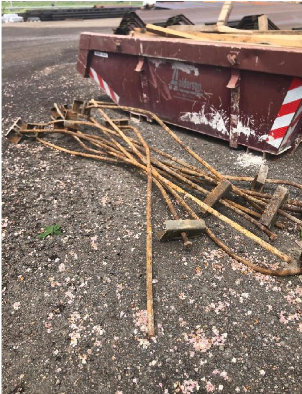
Figuur 79 Lange ankerstangen 'geen markering', waarschijnlijk ongeconserveerd.
