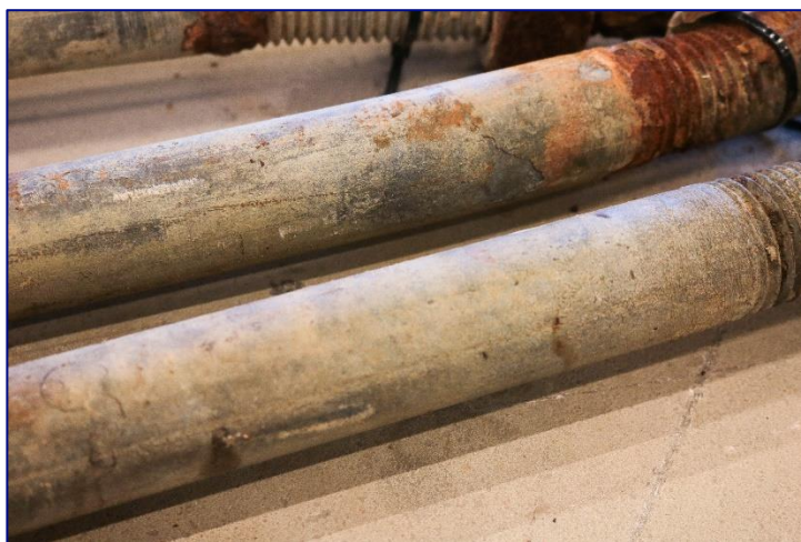
Figuur 61 Corrosie product detail stang locatie I.
