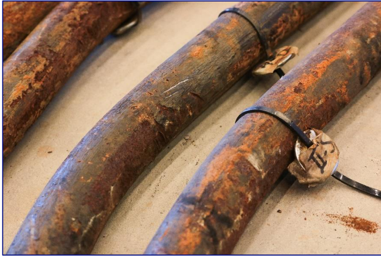
Figuur 68 Corrosie product ankers locatie II.
