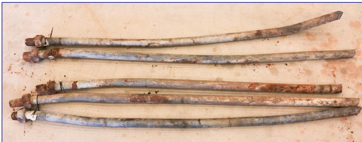
Figuur 60 Corrosie product ankers locatie I.
