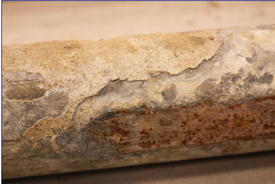
Figuur 54 Detail corrosie product locatie CTW.
